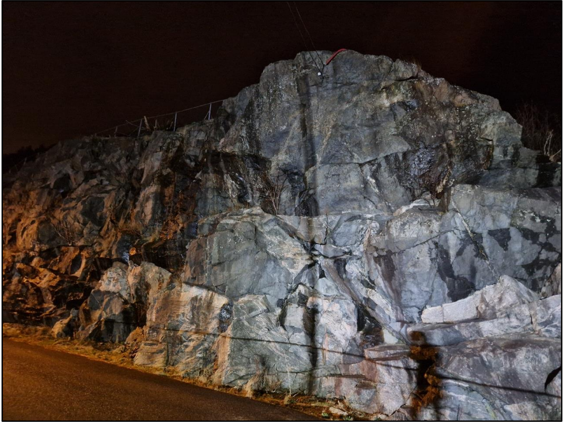
Figur 4: Bildet av den nest nordligste bergskrenten (2) med faresoner 1/1000 og 1/5000. Foto: Multiconsult
