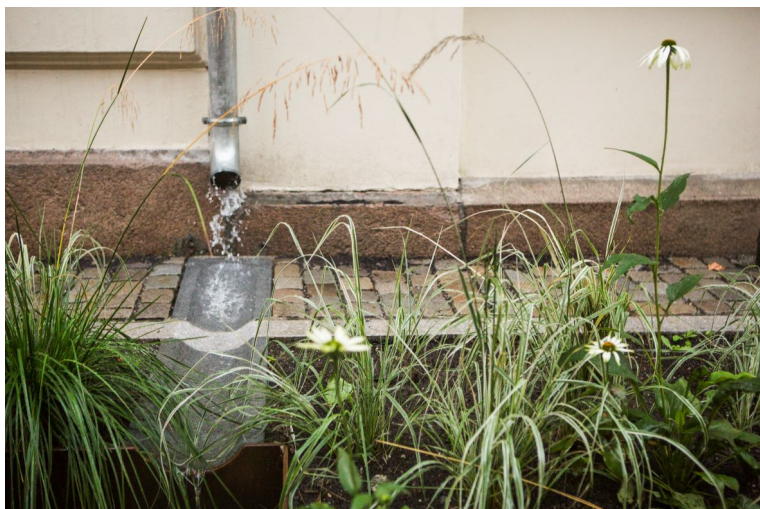
Figur 28: Eksempel på utforming av nedløp og innløp til plantefelt/regnbed (Foto: Asplan Viak / Åse Holte)
