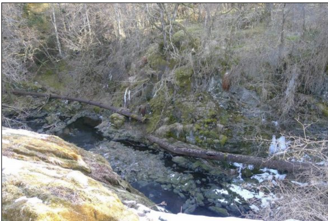
Fig.39: Rørgaten mellom Hylkjestemma og spinneriet er i svært dårlig forfatning (Kilde: Bergen kommune, Byantikvaren 2013)
