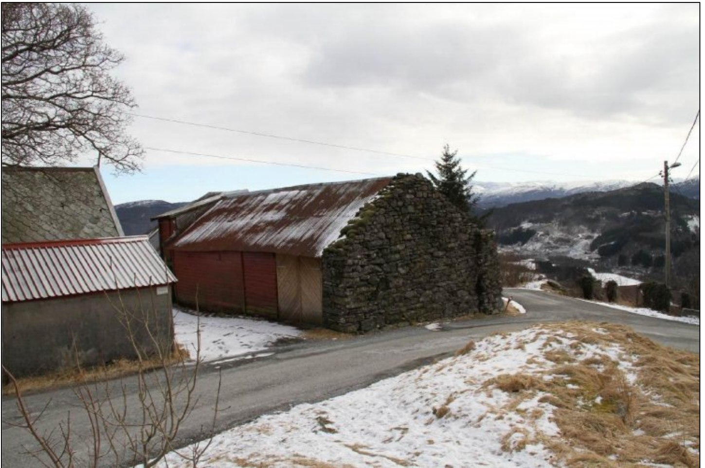
Fig.19: Løe på Sæterstøl, bnr.1 med gavlvegg av tørrmur, hele søndre langvegg er også av tørrmur (Kilde: Bergen kommune, Byantikvaren 2013).
