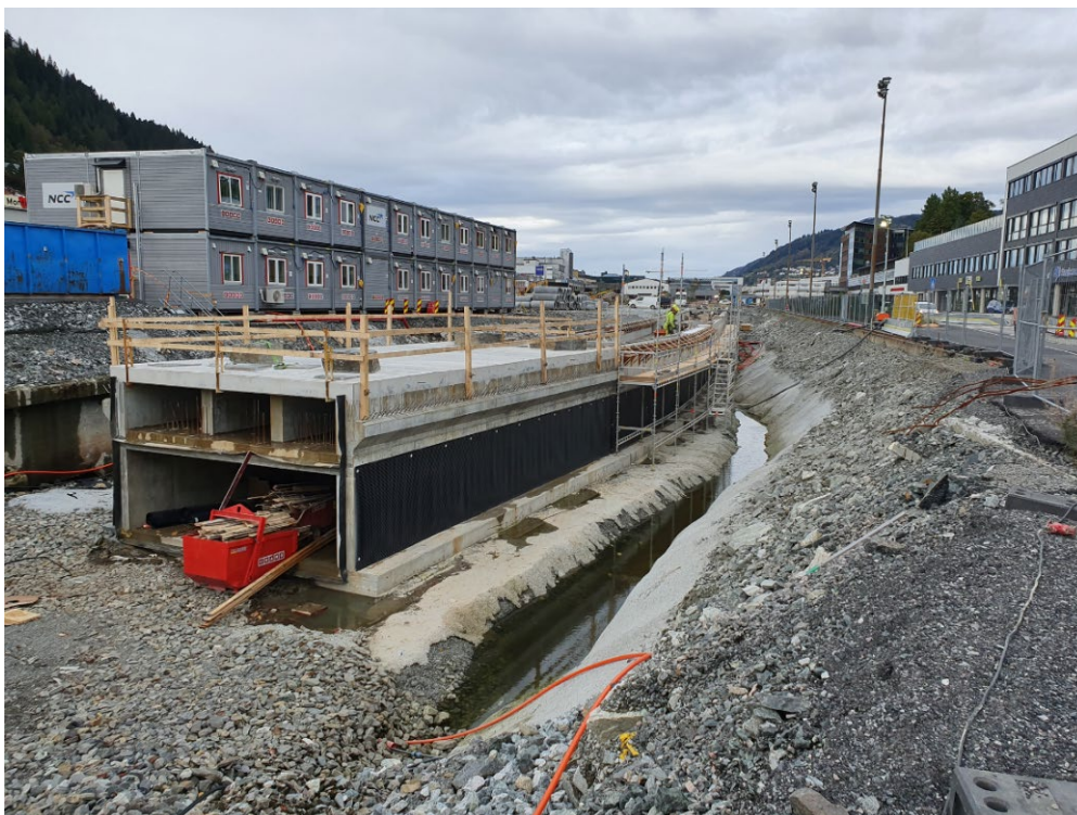
Figur 3-3: På Mindemyren er det gjennomført bekkeåpning med et to-etajers system, med flomkulvert i nedre løp og åpent vannspeil i øvre del.
