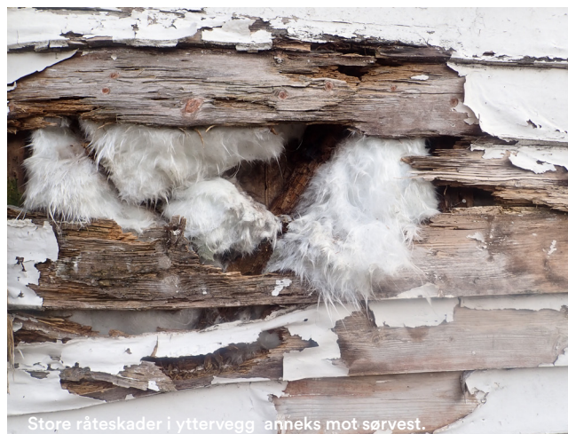
Store råteskader i yttervegg annekset mot sørvest.
