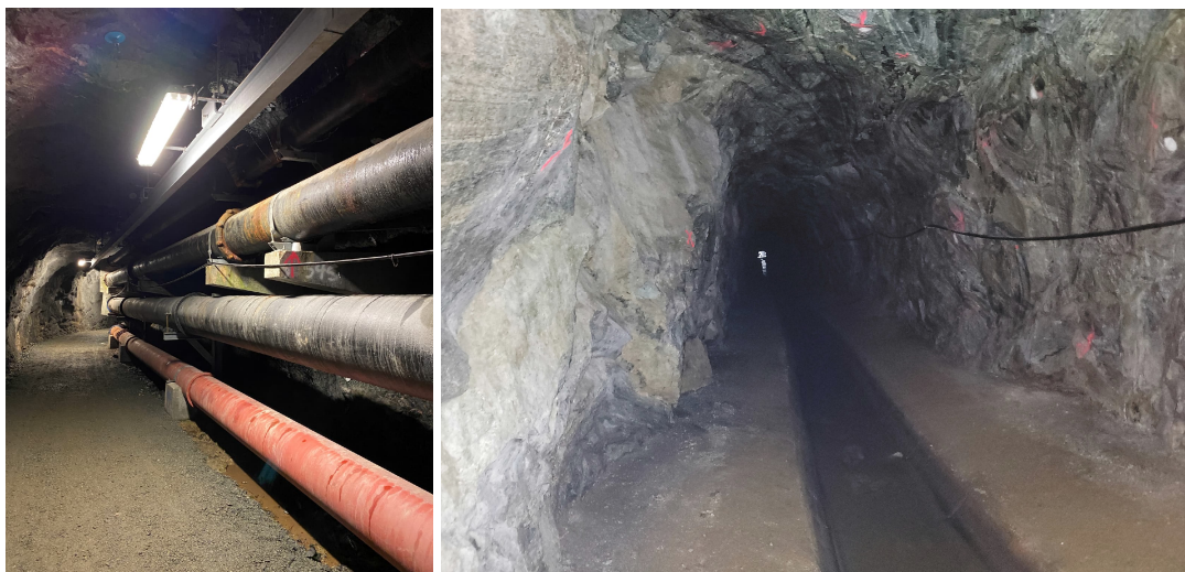
Figur 4 Det er stor forskjell på Bergen Vann sine tunnelanlegg, fra tunneler med f.eks. mye rørinstallasjoner (foto til venstre) og f.eks. overvanns/avløpstunneler uten noen installasjoner i (foto til høyre). Dette påvirker også hvor sårbare og kritiske de er for skader fra ev. blokkutfall o.l. som kan forårsakes fra berguttak/sprengning i nærheten.
