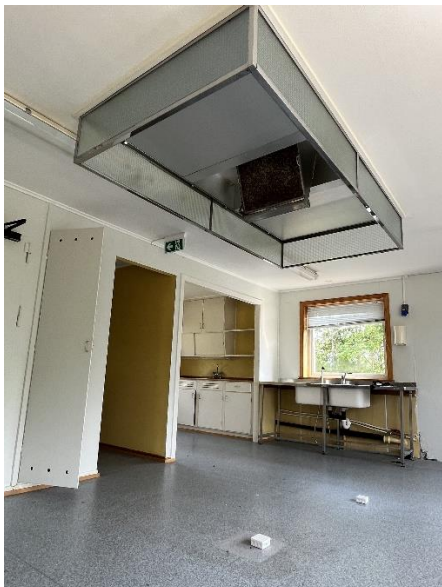
Figur 4-29 Fra hovedkjøkkenet, med stor avtrekksvifte i taket fra «G. Krogseth & Co», blikkenslagermester
