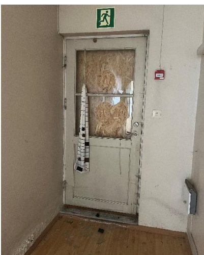
Figur 4-58 Dør ut til plassen bak østre fløy (jf. Figur 4-15) er knust.
