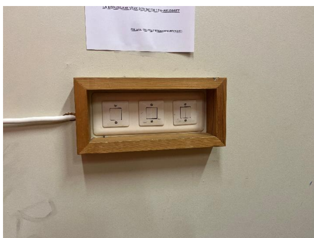
Figur 4-75 Detalj av lysbrytere i bygget
