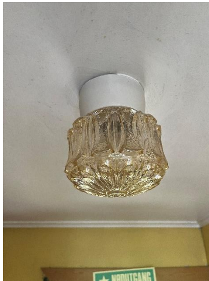
Figur 4-32 Detalj av lampe i gang
